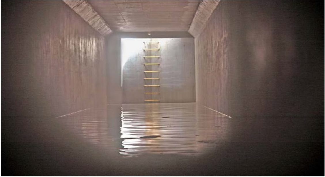
Şekil 5.5: NIOZ'daki 3 adet yer altı su tankından birinin iç görüntüsü
