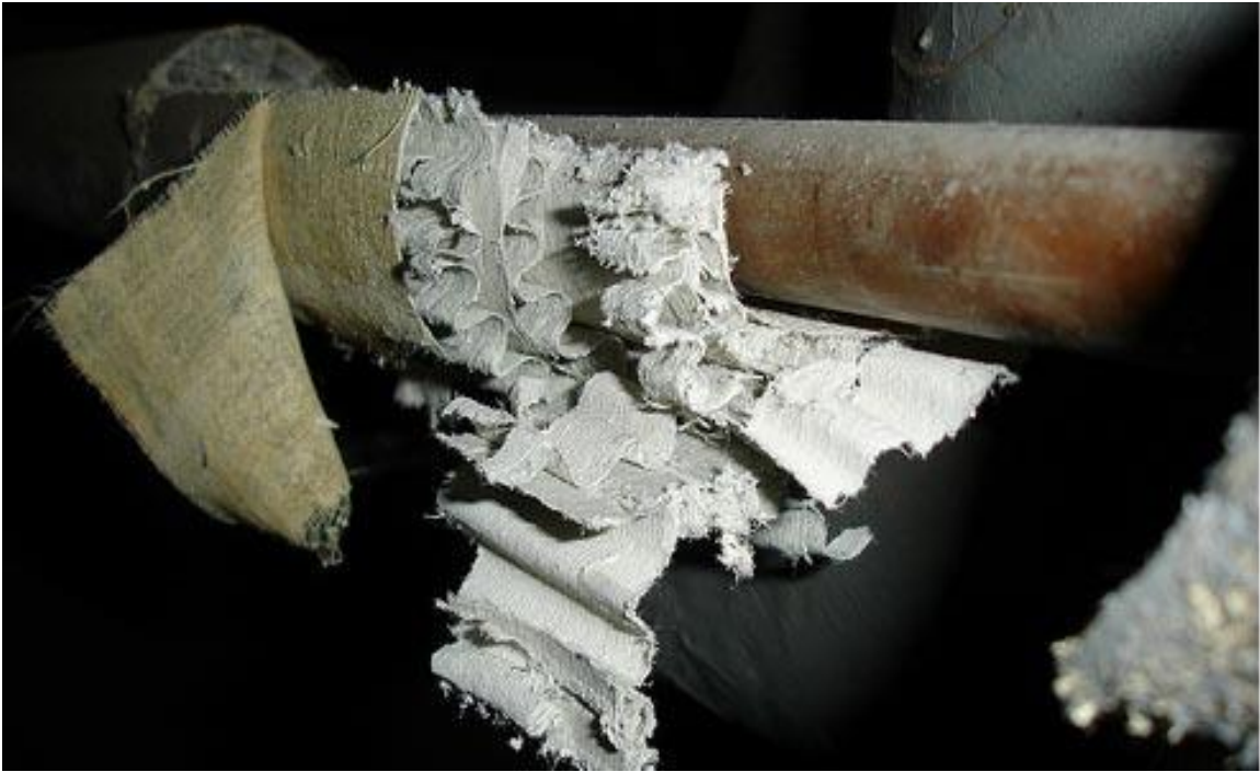
Şekil 5.2: Asbest ile izole edilmiş boru
